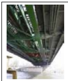
Слика 73. Панчевачки мост нападнут корозијом (снимак испод конструкције моста)
